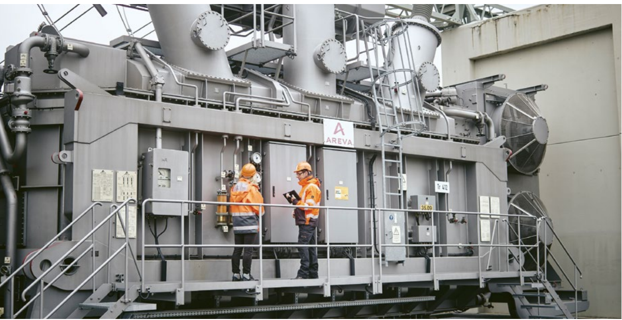
Ein Mitarbeiter von 50Hertz arbeitet an einem Transformator im Umspannwerk Wolmirstedt bei Magdeburg.
