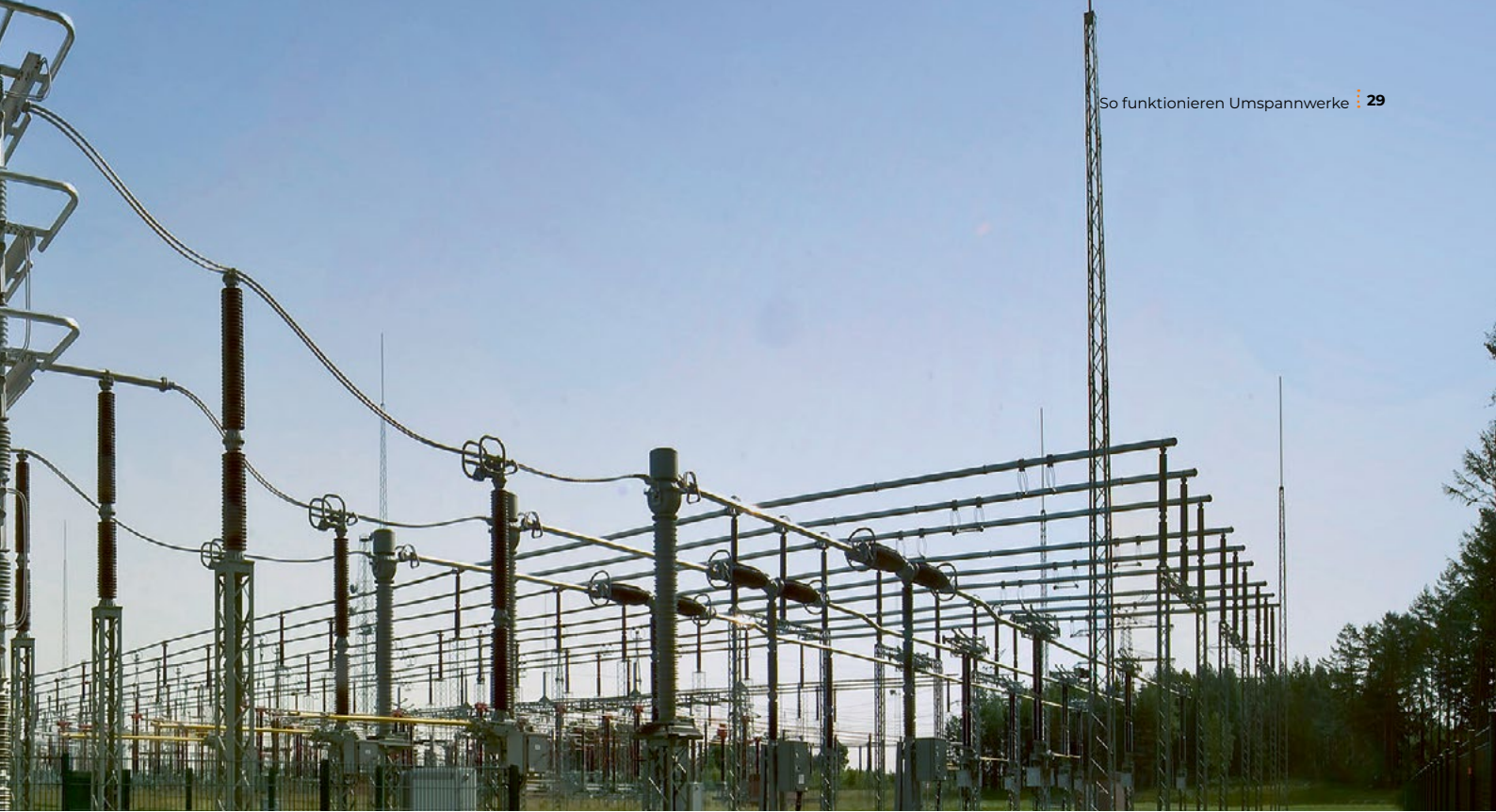
Die Blindleistungskompensationsanlage im Umspannwerk Altenfeld in Thüringen.
