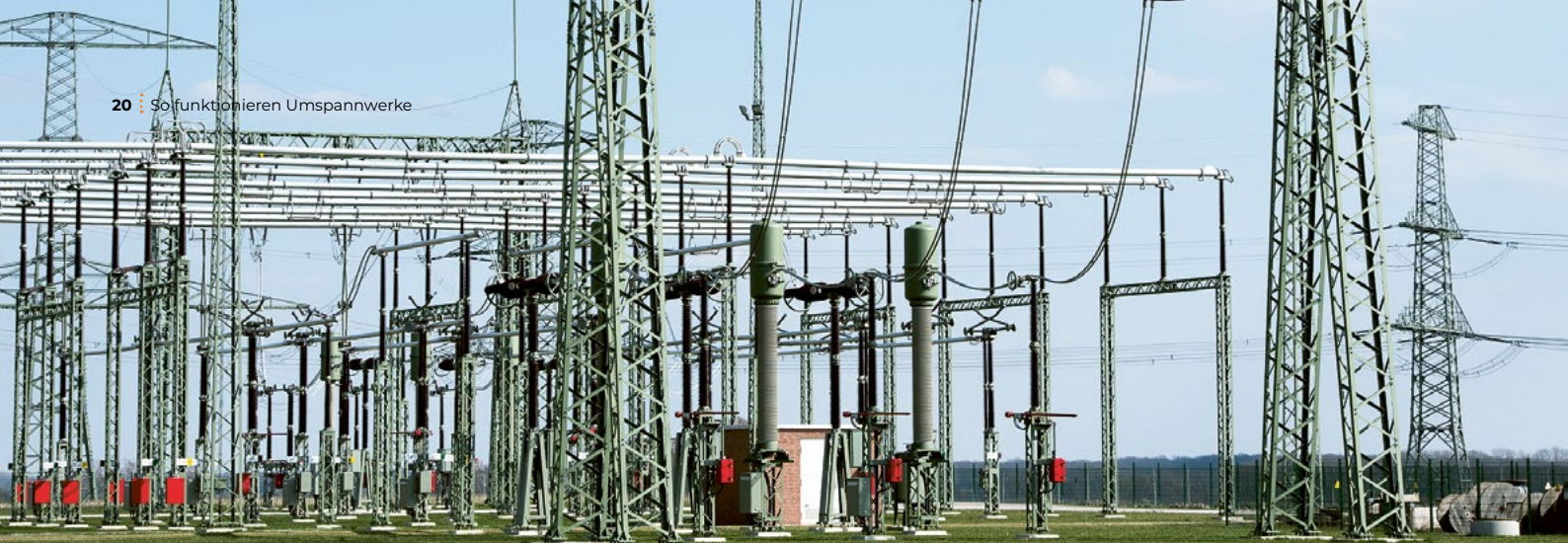
Blick in eine 380-Kilovolt-Schaltanlage in einem 50Hertz-Umspannwerk.
