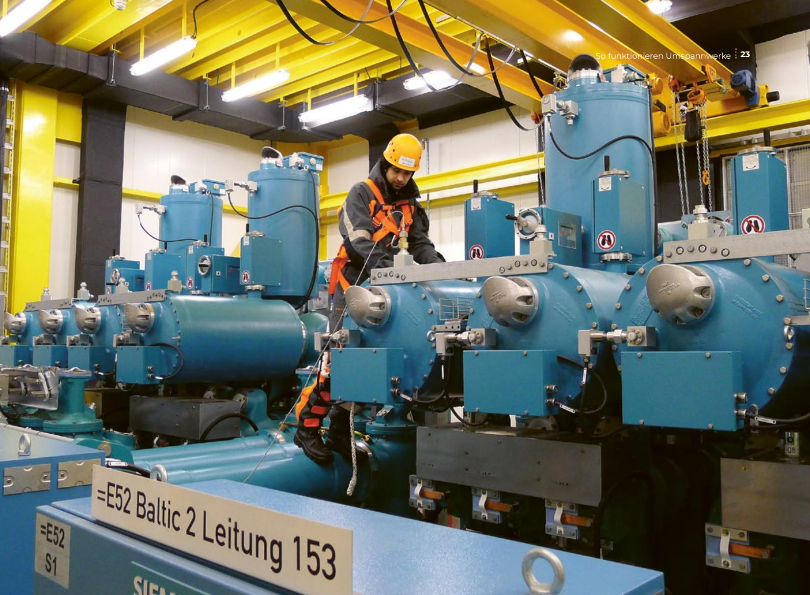
Kontrollarbeiten in der Schaltanlage auf der Plattform des Offshore-Windparks Baltic 1.
